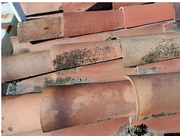
Detalle de vegetación y tejas levantadas a contrapendiente
