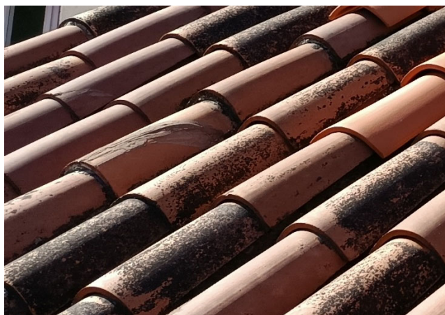
Tejas rotas con sellados y con sustituciones de distinta curvatura.
